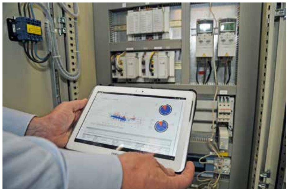
Monitoring-Tools bieten einen detaillierten Einblick in sämtliche Prozesse rund um den Betrieb von gebäudetechnischen Anlagen. Foto: Priva Building Intelligence GmbH
