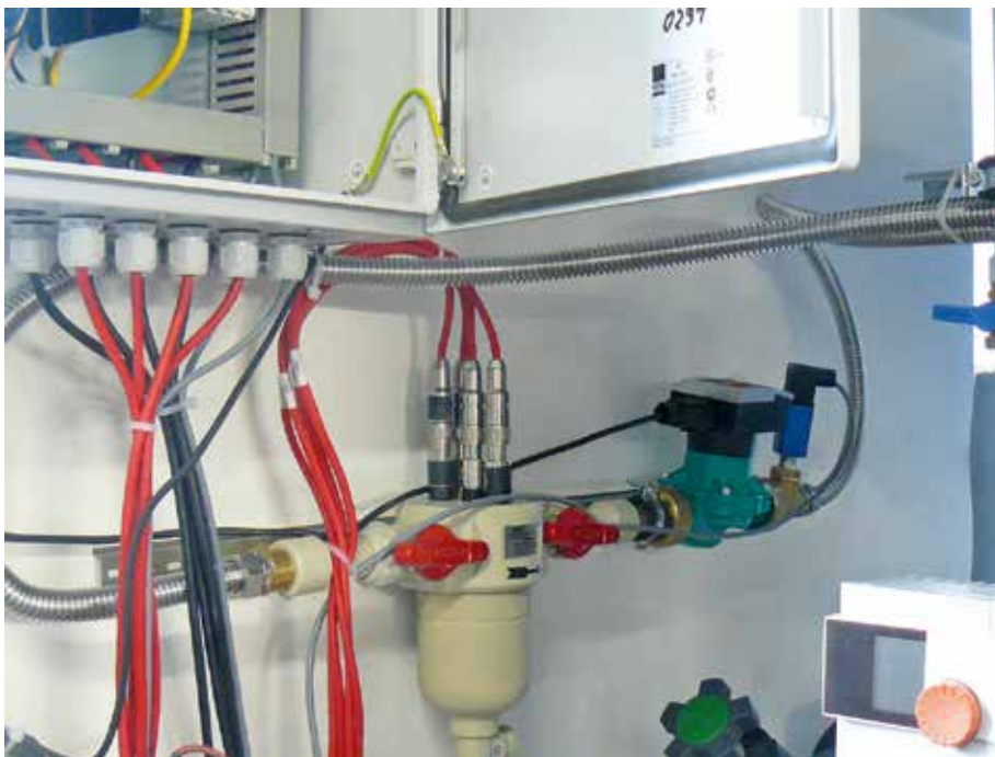
Abbildung 3: Mit sauerstoffdiffusionsdichtem Edelstahl-Wellschlauch angebundene Korrosions-Messstrecke mit Datenlogger und DFÜ-Schaltschrank Foto: SIZ energie+
