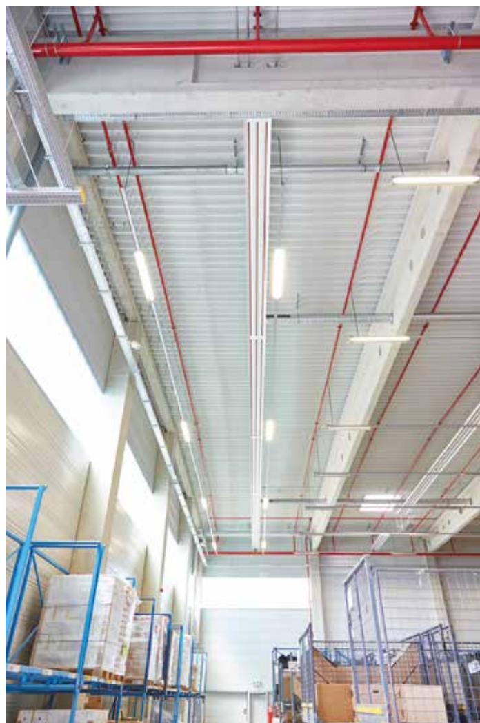
Abbildung 5: Die verbauten Deckenstrahlplatten sind jeweils 460 mm breit.
