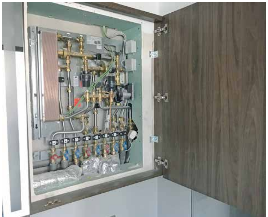
Abbildung 3: „Regudis W“-Wohnungsstation im Apartment
