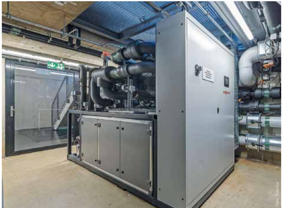
Abbildung 3: Solarlux-Energiezentrale in Melle: Die projektbezogen konzipierte Vitocal Spezial-Wärmepumpe bezieht ihre Energie aus 76 Erdwärmesonden, die jeweils 80 Meter tief sind.
