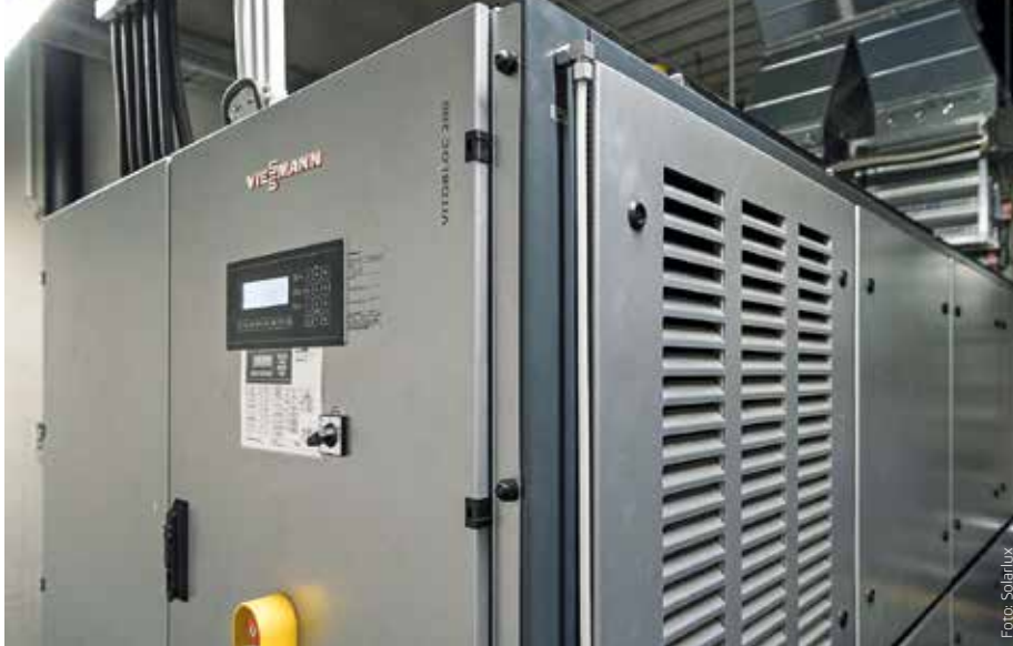
Abbildung 5: Blockheizkraftwerk Vitobloc 200. Bei einem Ausfall der Netzspannung übernimmt das BHKW die Stromversorgung und gewährleistet den Weiterbetrieb wichtiger Anlagen in der Produktion.
