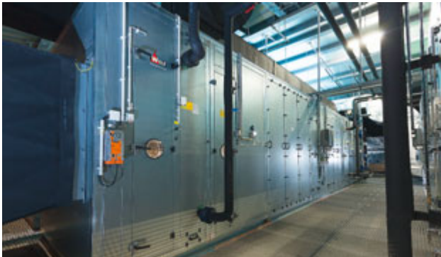
Zwei redundante WK-com Zu- und Abluftgeräte übernehmen die Hauptlast der Lüftung.
