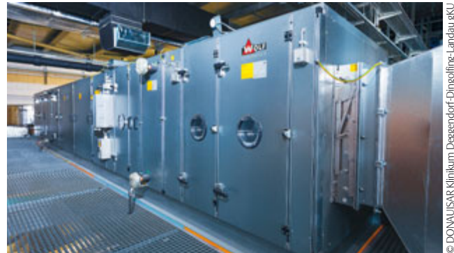
Zonengeräte in Hygiene-Ausführung versorgen die OPs mit perfekt aufbereiteter Frischluft (Bild zeigt Baufortschritt).
