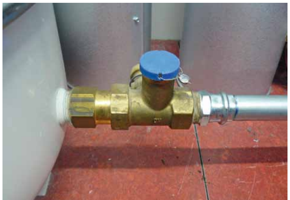
Abbildung 2: Messingfitting in einer Anlage aus verzinktem Schwarzstahl
