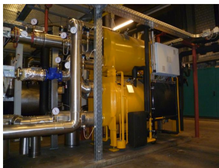
Foto (TU Berlin): Neue Absorptionskälteanlage beim Vivantes Klinikum Spandau.
