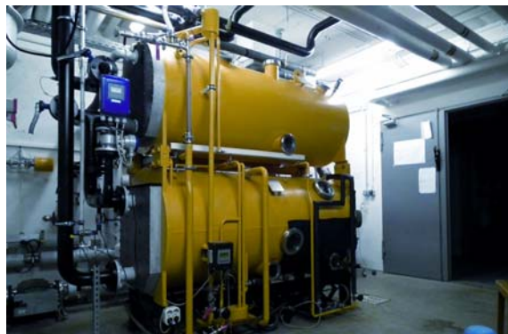
Foto: Neue Absorptionskälteanlage für KWKK-Systeme (Kraft-Wärme-Kälte-Koppelung) der TU Dresden.
