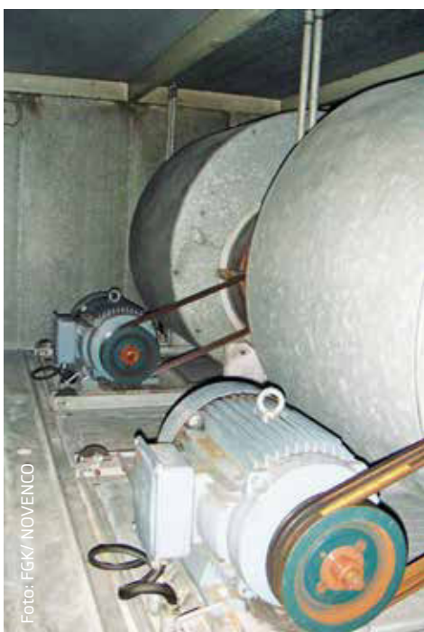
Abbildung 6: Radialventilator vor der Modernisierung
