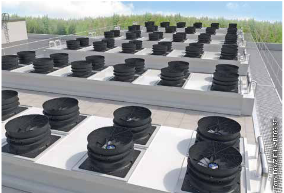
Abbildung 5: Rückkühler mit effizienter EC-Technologie nach der Modernisierung
