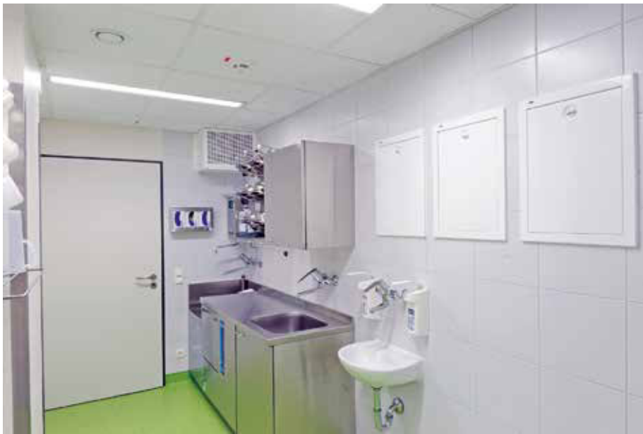
Abbildung 4: Zentraler Bestandteil des Trinkwasser-Hygieneconzepts des Allgemeinen Krankenhauses Celle: Die hoch komplexe Trinkwasser-Installation wurde in sanitärtechnische „Funktionseinheiten“ zerlegt und durch realistische Gleichzeitigkeiten „schlanker“ ausgelegt.
