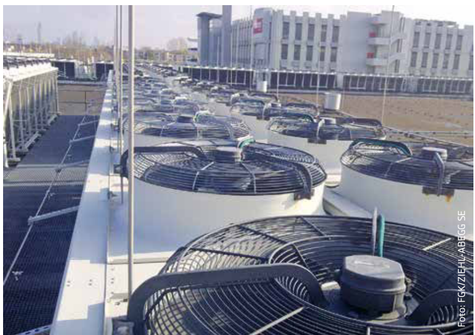
Abbildung 4: Rückkühler mit AC-Technologie vor der Modernisierung
