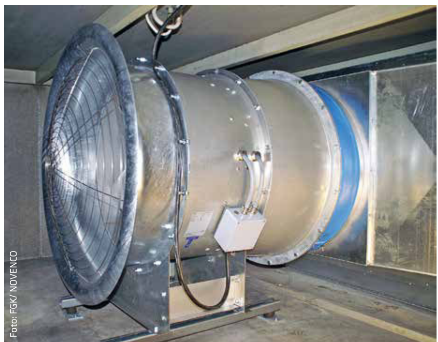
Abbildung 7: Axialventilator nach der Modernisierung
