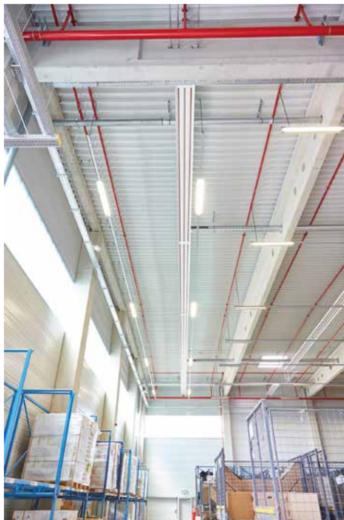
Abbildung 5: Die verbauten Deckenstrahlplatten sind jeweils 460 mm breit.
