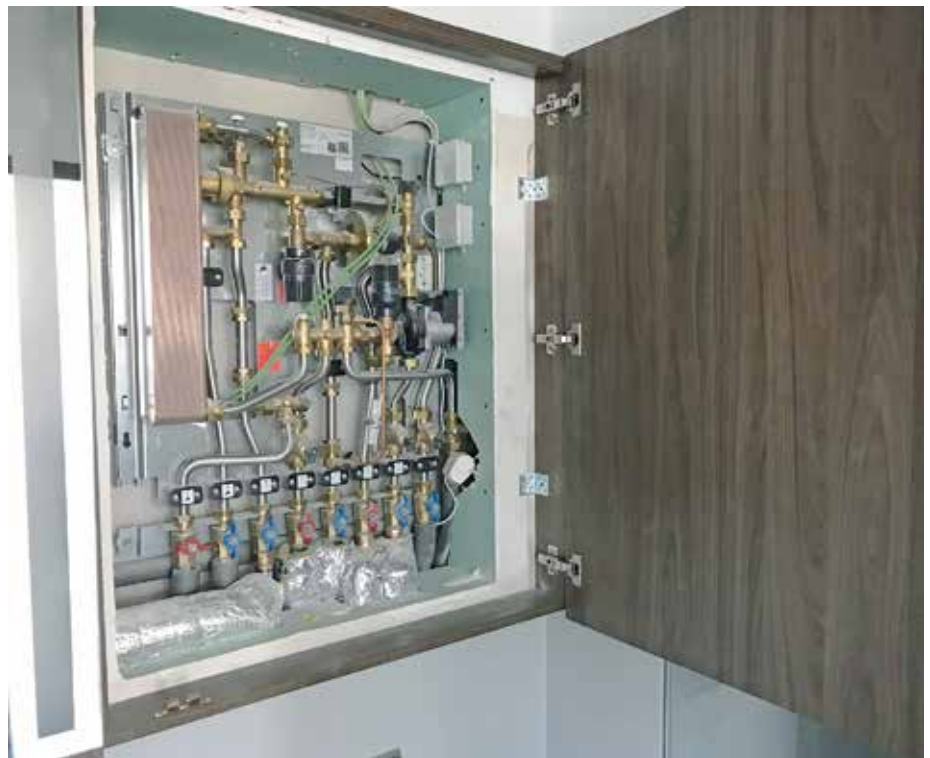
Abbildung 3: „Regudis W“-Wohnungsstation im Apartment
