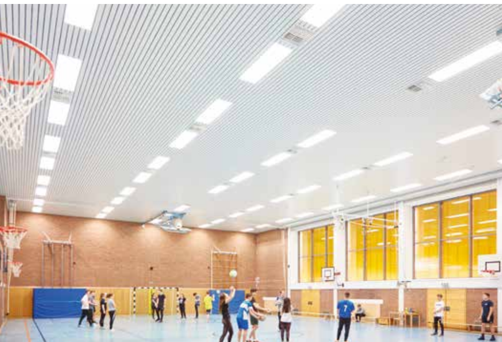
Abbildung 5: Energiesparende, ballwurfsichere LED-Leuchten können direkt in die Deckenstrahlheizung integriert werden.
