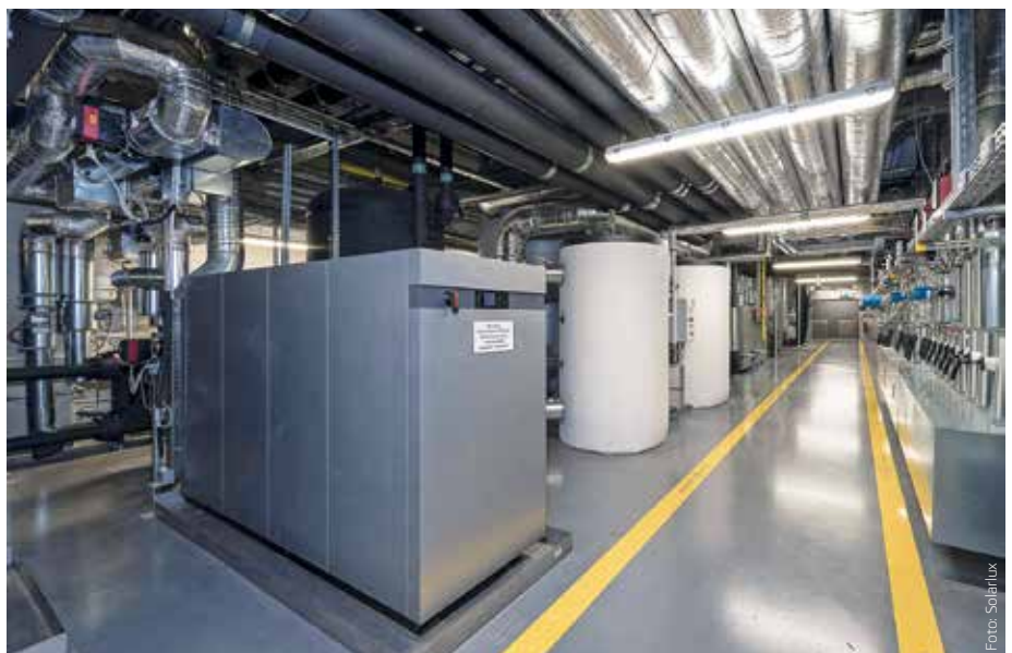
Abbildung 4: Im Vordergrund die in Serie gefertigte Großwärmepumpe Vitocal 300-G Pro mit 186 kW Wärmeleistung.
