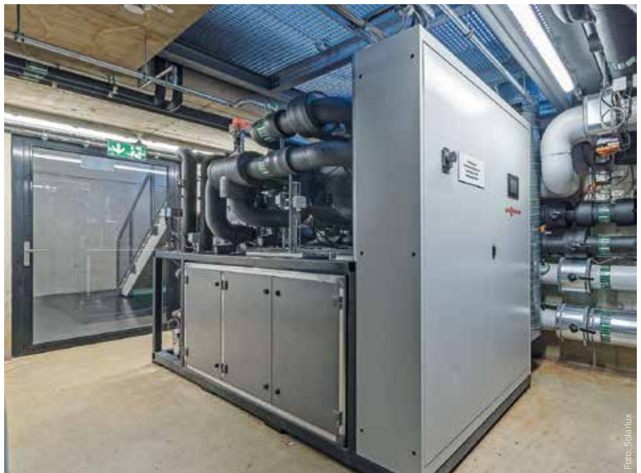
Abbildung 3: Solarlux-Energiezentrale in Melle: Die projektbezogen konzipierte Vitocal Spezial-Wärmepumpe bezieht ihre Energie aus 76 Erdwärmesonden, die jeweils 80 Meter tief sind.
