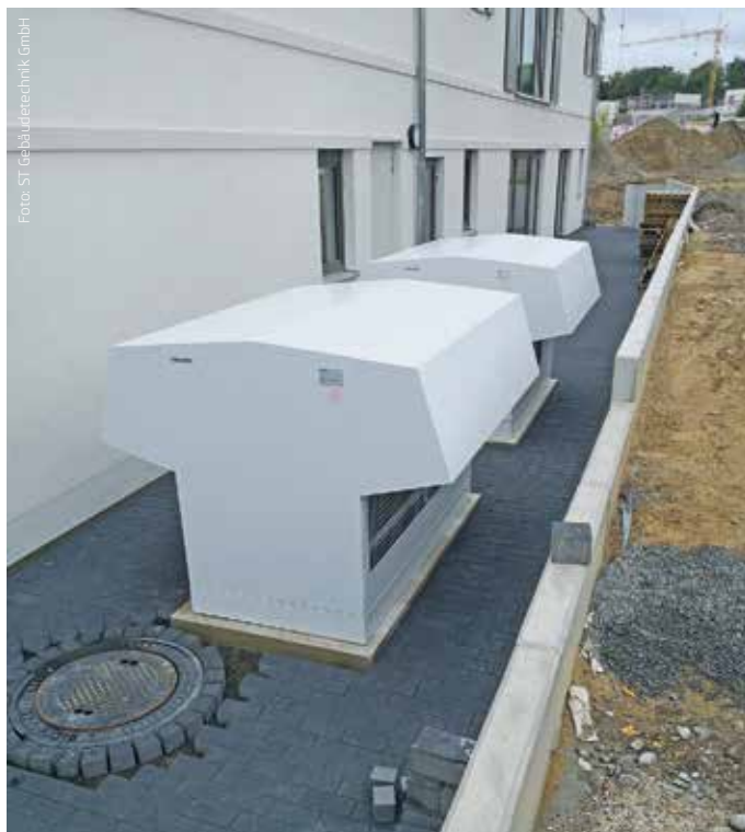
Abbildung 1: Die Abstandsregeln des Herstellers wurden nicht eingehalten.
