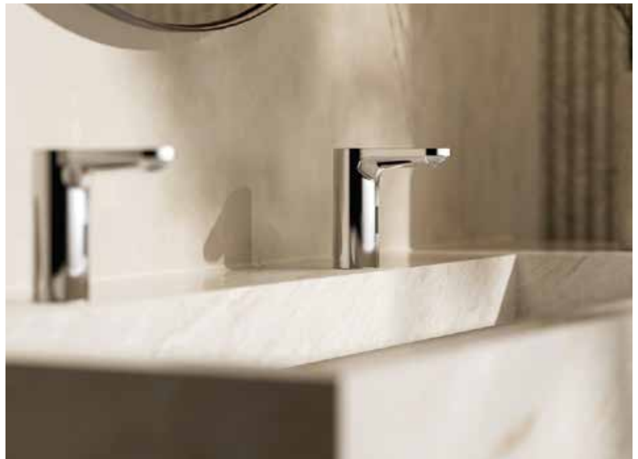
Abbildung 2: Elektronische, berührungslose Waschtisch-Armaturen können den Wasserverbrauch im Vergleich zu regulären Einhebelmischern um bis zu 70 Prozent verringern – und damit auch die Energiekosten für die Erwärmung des Warmwassers.
