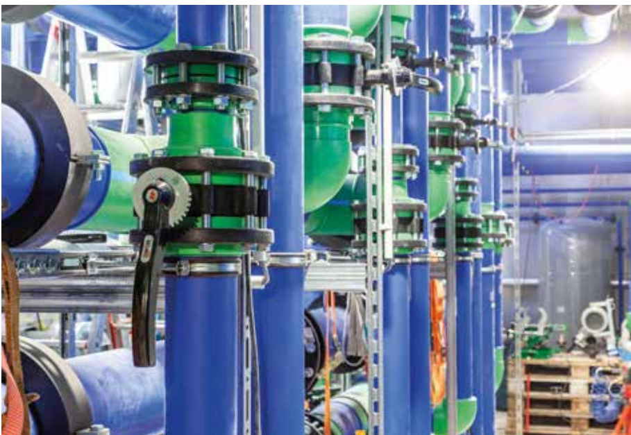
Abbildung 2: Das Rohrleitungssystem der gesamten zentralen Anlagentechnik zu den einzelnen Komponenten des Energiekonzepts besteht aus dem korrosionsbeständigen Kunststoff Polypropylen.
