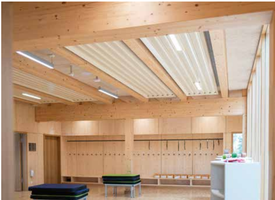
Abbildung 3: Der seitliche Abstand der Deckenstrahlplatten zu den Holzbalken beträgt jeweils nur sechs Zentimeter.
