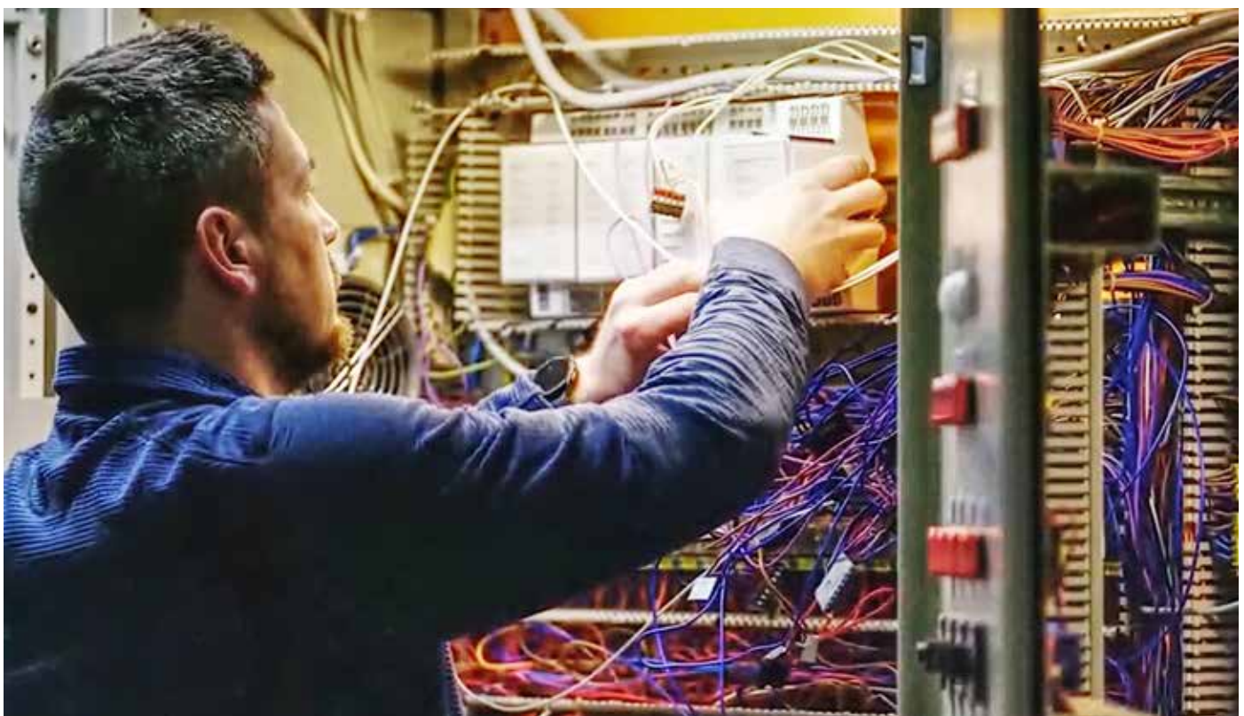
Abbildung 3: Eine proaktive Kommunikation ermöglicht den einfachen Zugang zu Technikräumen.
