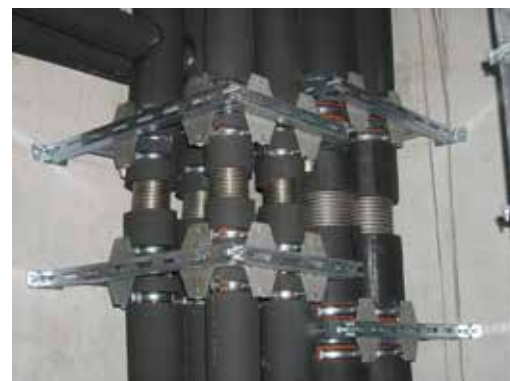
Abbildung 12: Steigleitungen mit Axial- kompensatoren
