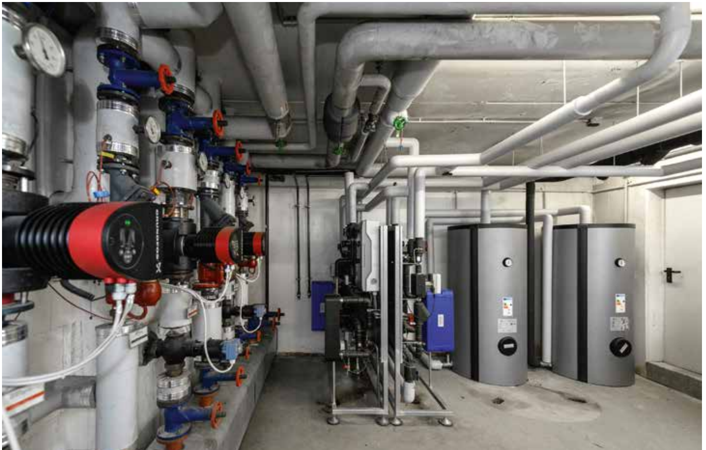
Abbildung 3: Der Klassiker in der PWH-Versorgung im Geschosswohnungsbau ist eine zentrale Bereitstellung – hier per Fernwärme und Bereitstellung über hinreichend dimensionierte Trinkwasserspeicher.
